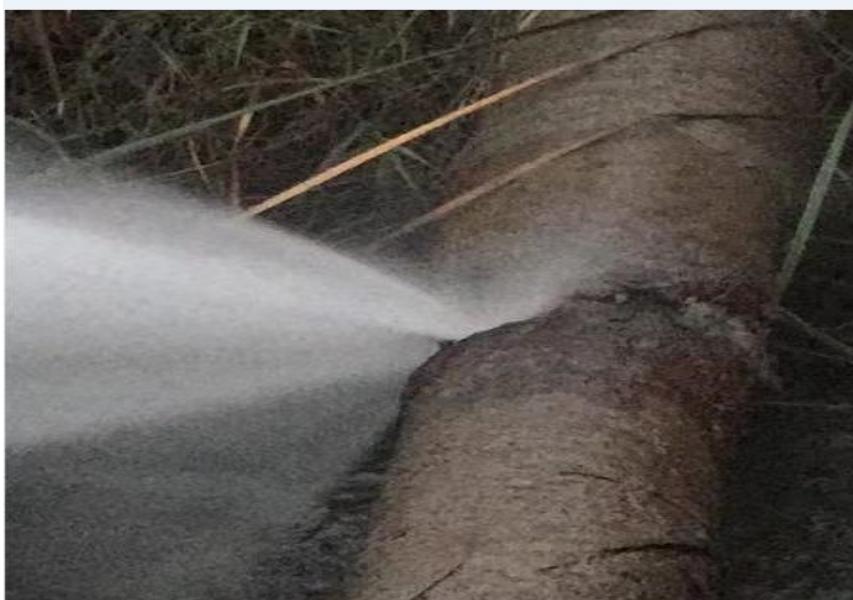
图 2.3-7 单 13 号站注水干线穿孔腐蚀穿孔照片
