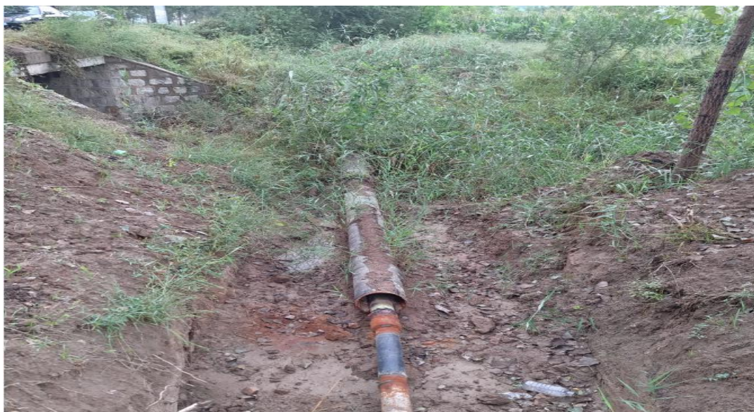
图 2.3-5 林西老线(南王村东至林一接转站段)注水干线腐蚀穿孔照片
